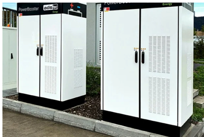
Abbildung 14 - Außenspeicher Bsp. (Quelle: www.ads-tec-energie.com )
